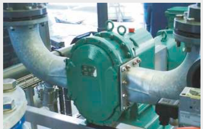
Una bomba TORNADO® para aguas residuales con 1-3% de sólidos en un sistema de filtro de membrana para caudal de hasta 80 m³/h en ambos los sentidos de rotación.
