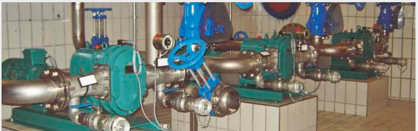
Aplicación en el tratamiento de aguas servidas y aguas residuales con 3% de TS, con caudal de 55 m 3 /h y presión de 2 bar.
