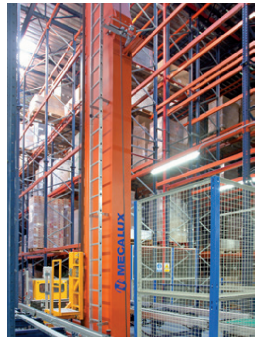
Almacén automático de doble profundidad (2).
